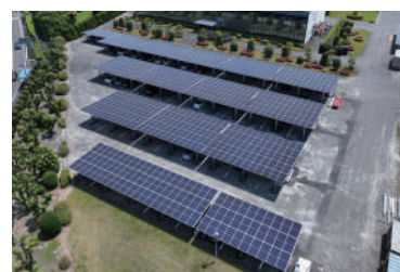
●設置方式: カーポート
