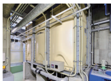
生産水槽 作られた純水を搬送し、塩素やミネラル分を添加し処理終了、生産水槽に一旦貯留しCCHに供給する。水質のモニタリングもこの水槽で実施します。
