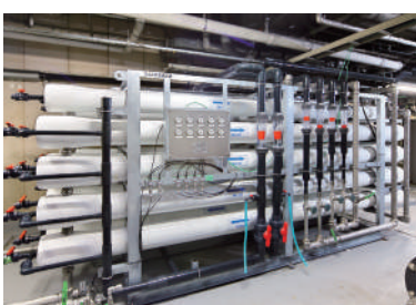
逆浸透膜(RO膜)処理装置 高い圧力で送られた処理水をRO逆浸透膜を通すことにより、不純物を分離し純水を生産します。
