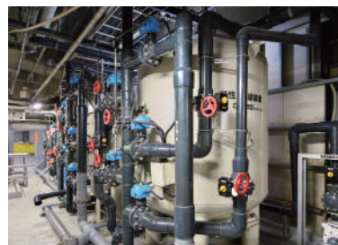
除鉄・除マンガンろ過装置 活性炭ろ過装置 貯留している井戸水をポンプで圧送しろ過装置で一次処理をします。 (鉄分、マンガン分、におい、濁り等を除去)
