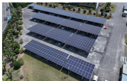
●設置方式: カーポート
