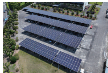
●設置方式: カーポート
