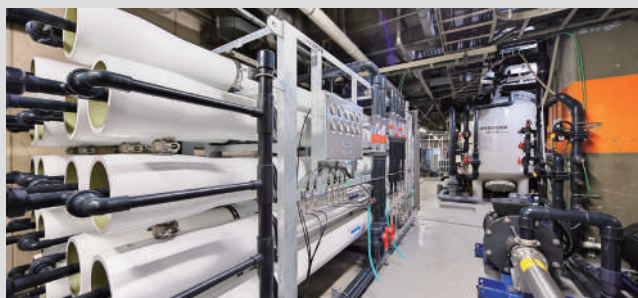
キャナルシティ井水プラント(サウス棟地下2階)
