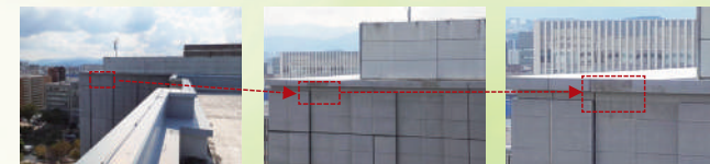
遠景：東側 パラベット劣化箇所 パラベット劣化箇所
