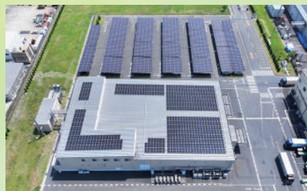
●設置方式：屋根置き・カーポート
