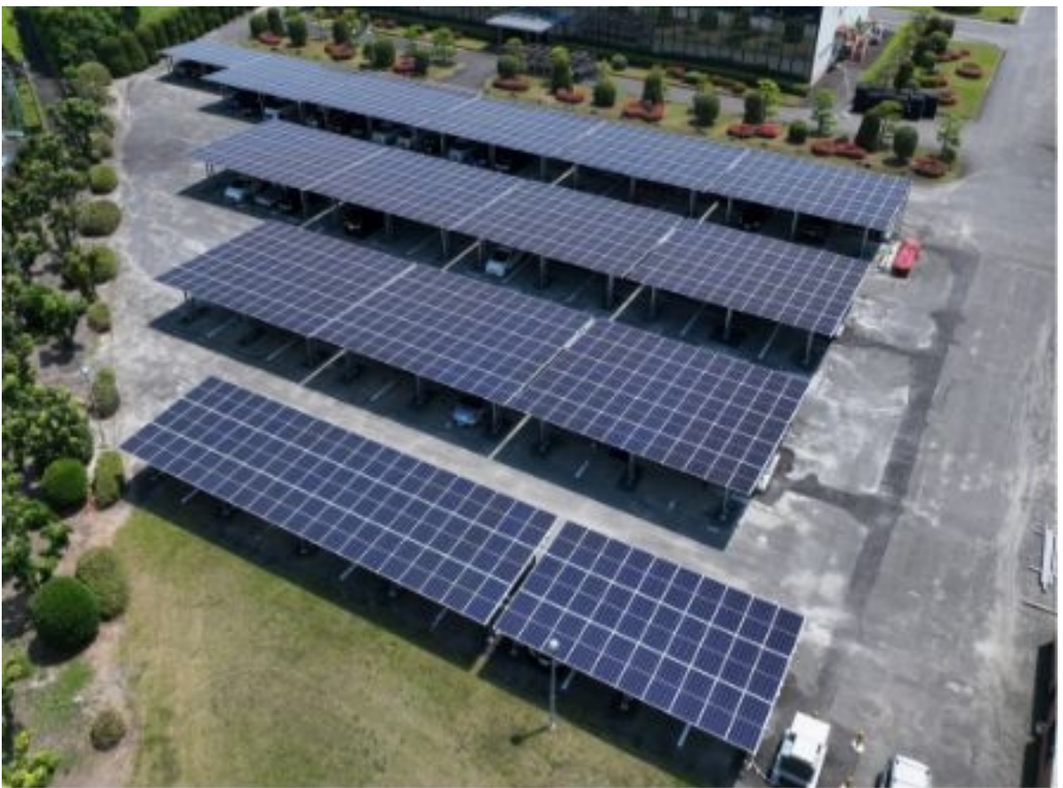
設置方式：カーポート
