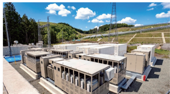
系統用蓄電所
