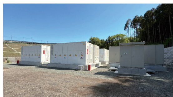
系統用蓄電所
