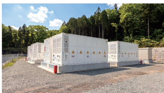
系統用蓄電所
