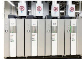
ボイラー (温熱)
