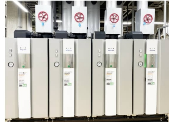
ボイラー (温熱)
