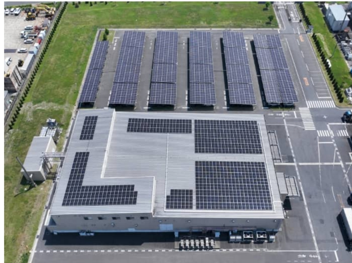
設置方式：屋根置き・カーポート
