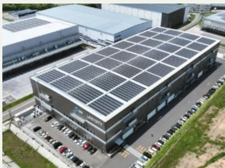
設置方式：屋根置き 福岡県小郡市
