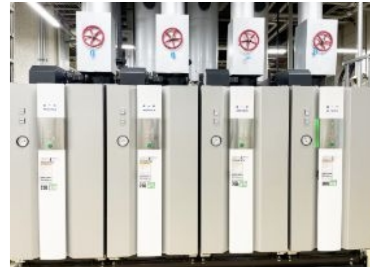
ボイラー (温熱)
