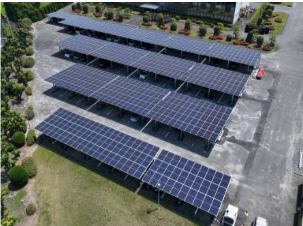
設置方式：カーポート
