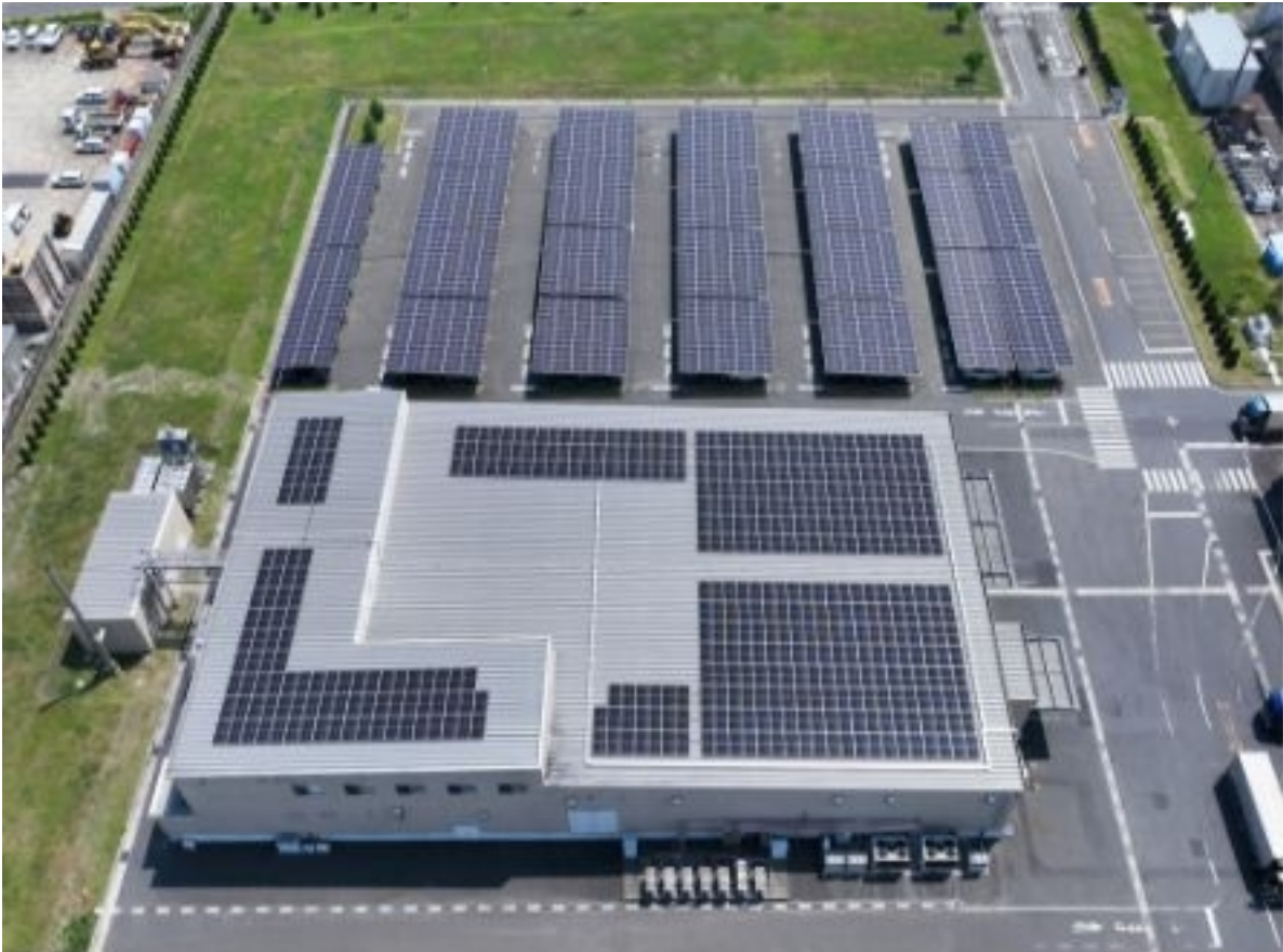
設置方式：屋根置き・カーポート
