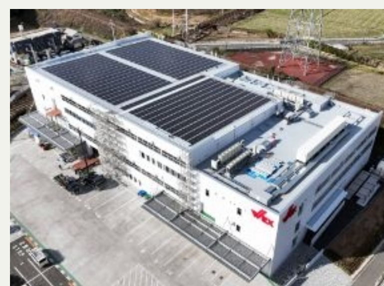
設置方式：屋根置き 福岡県筑紫野市
